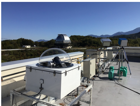
図 3.22: 屋上に設置されている外部機関カメラ収納箱（手前）
